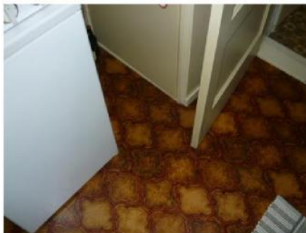
Voorbeelden asbesthoudend vloerzeil
